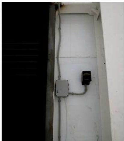
Правильно смонтированная распределительная коробка
