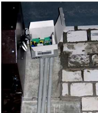
Неправильно смонтированная распределительная коробка :)))
